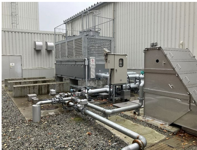
滑川製造所で導入した冷却ユニット
