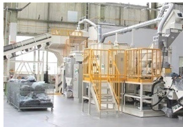
RPF製造設備（黒部越湖製造所）
