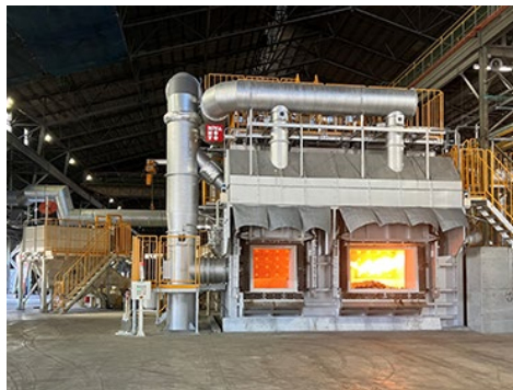
四国製造所 リサイクル炉
