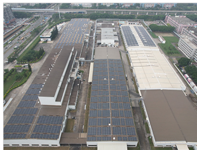
中国社（深圳工場） 440kW（2020年度） 920kW（2021年度） 900kW（2022年度）
