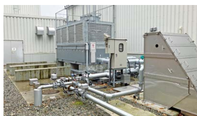
滑川製造所の冷却ユニット
