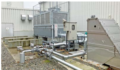
滑川製造所の冷却ユニット
