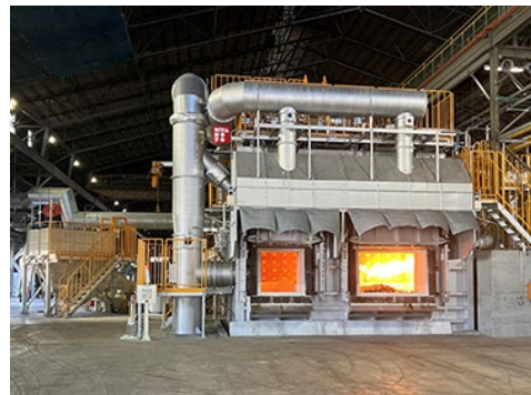
四国製造所 リサイクル炉
