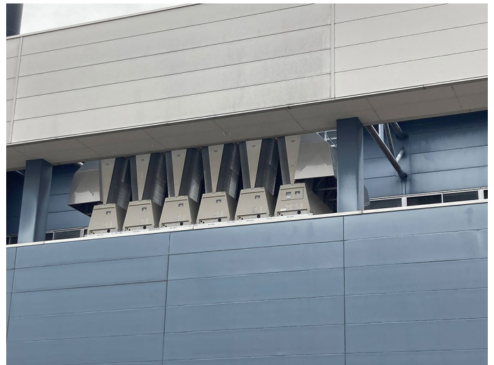
更新された電気式モジュールチラー
