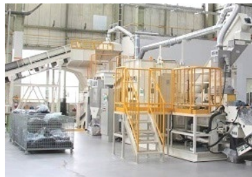
RPF製造設備（黒部越湖製造所）
