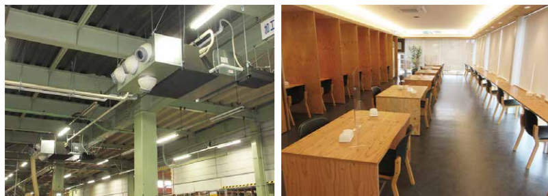
職場環境整備の一環として、東北製造所には空調設備を大幅に増設(左)。四国製造所にはサテライト食堂を2カ所開設(右)。
